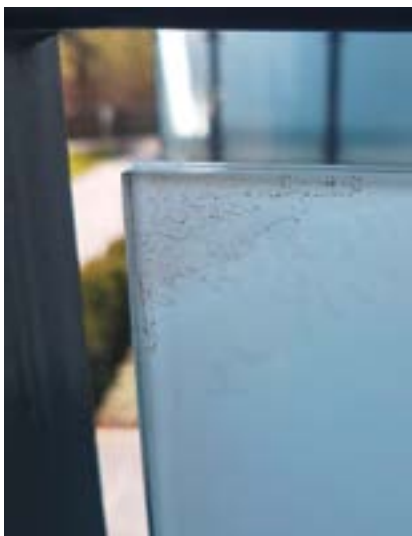
Delamination der betroffenen Glasscheiben
